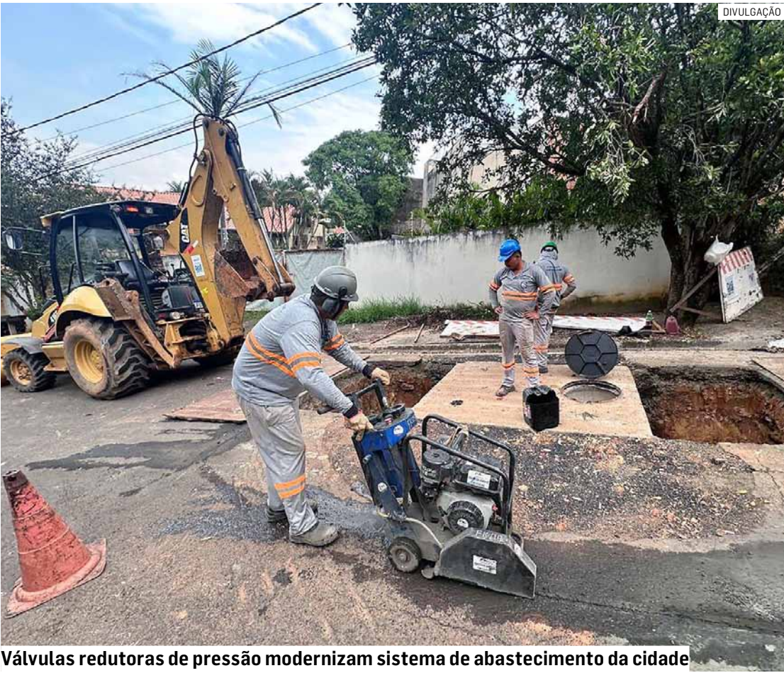
Válvulas redutoras de pressão modernizam sistema de abastecimento da cidade
