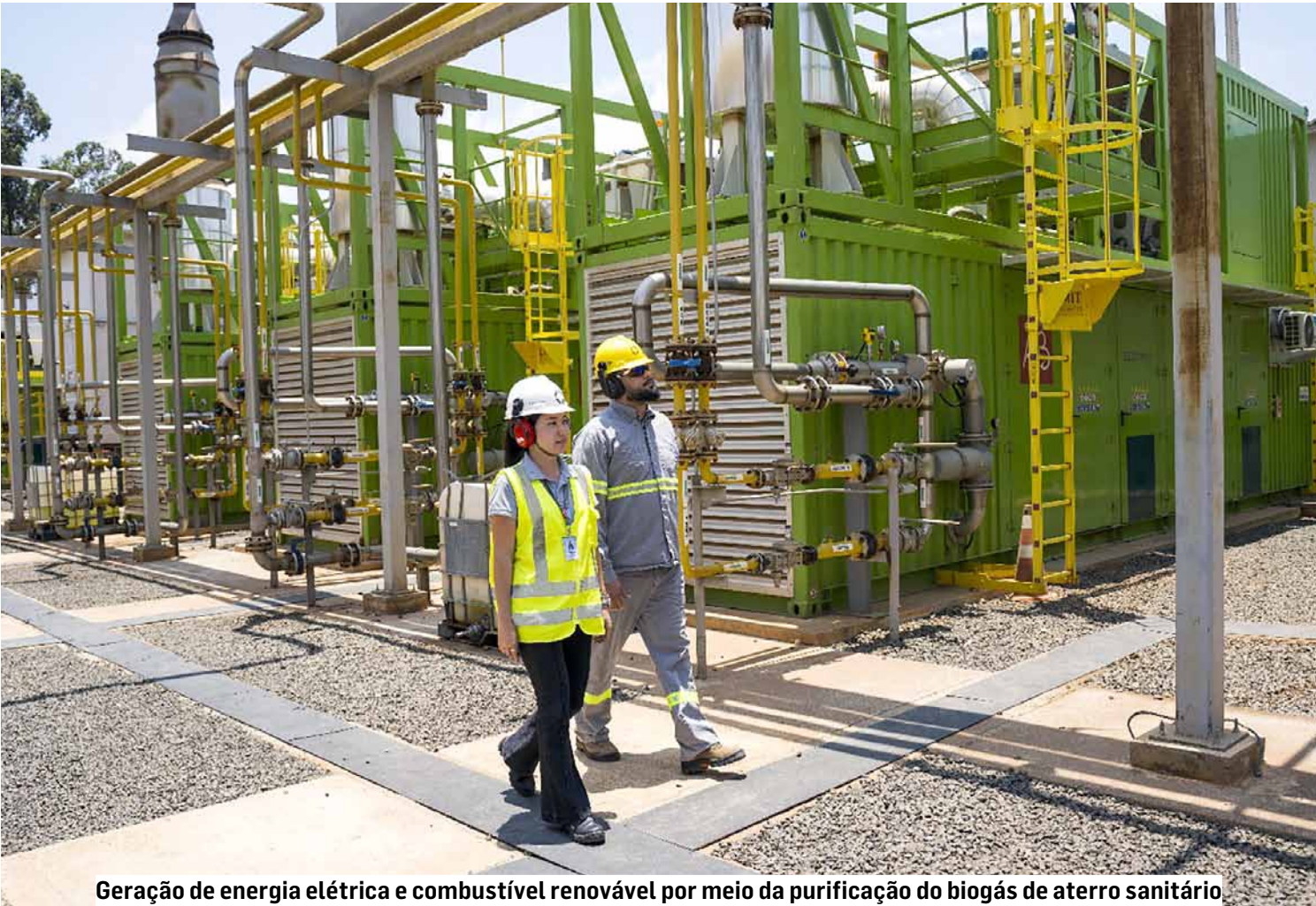
Geração de energia elétrica e combustível renovável por meio da purificação do biogás de aterro sanitário
