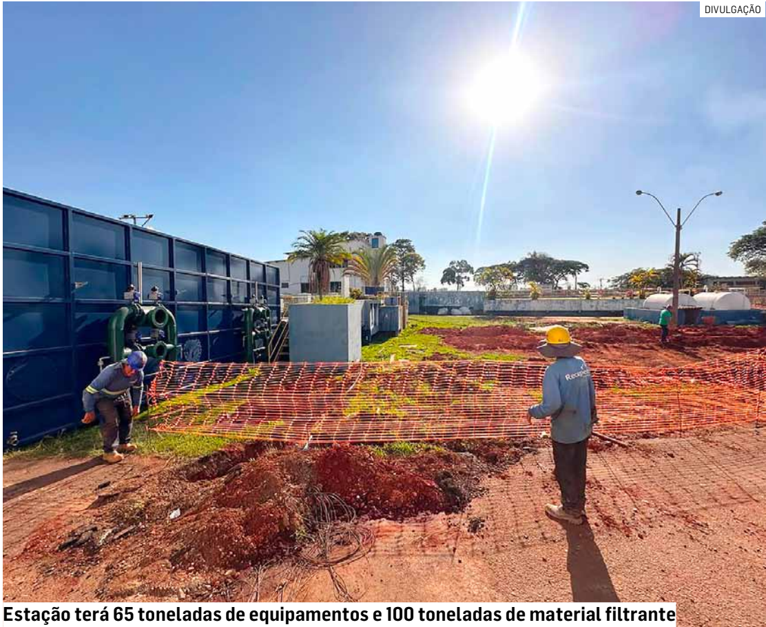
Estação terá 65 toneladas de equipamentos e 100 toneladas de material filtrante
