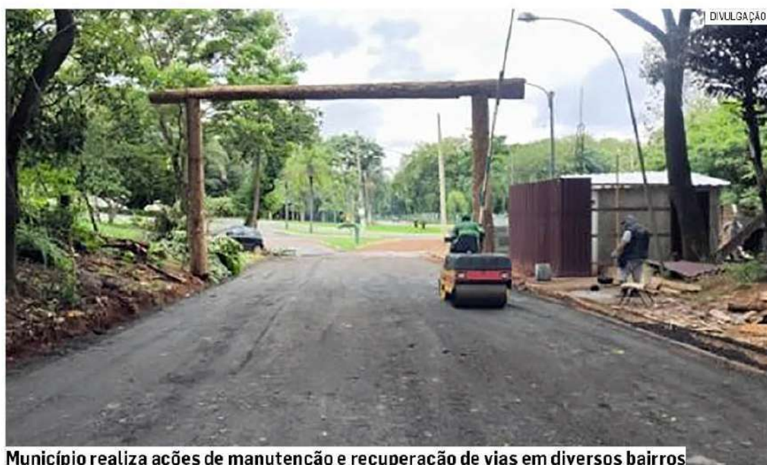
Município realiza ações de manutenção e recuperação de vias em diversos bairros
